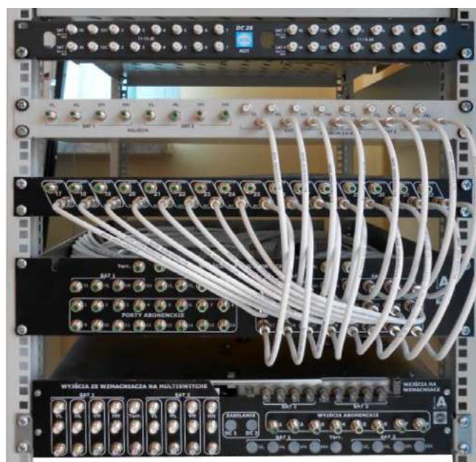
Fot 5. Punkt Styku (punkt kolokacji urządzeń).
