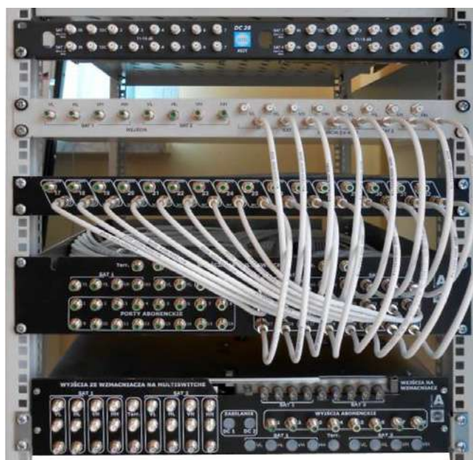
Fot 5. Punkt Styku (punkt kolokacji urządzeń).
