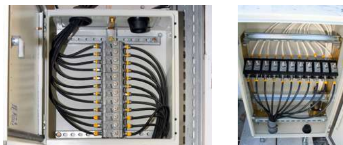
Fot. 4. Szafki z ogranicznikami przepięć do ochrony instalacji antenowej.
